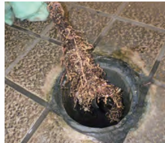
▲小便器排水管内の毛だまり
