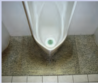
▲小便器周辺の床の変色
