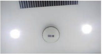
▲トイレの天井に設置されたボンボア
