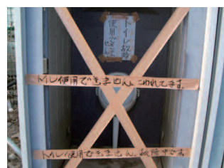
▲故障し、使用禁止になっている
