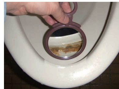
▲洋式大便秘器リム部内側に発生した尿石
